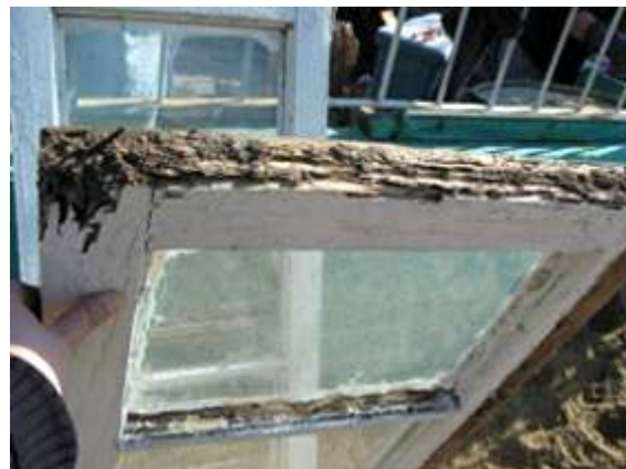
Ventana con daño de termita subterránea.
