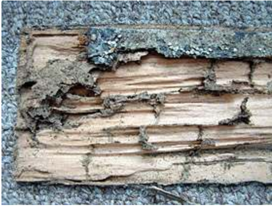
Foto 32: Daño en piso de parquet, Reticulitermes flavipes .
