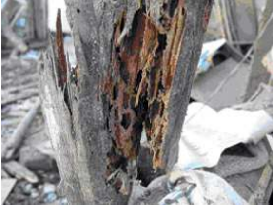
Foto 29: Viga dañada por Reticulitermes flavipes .
