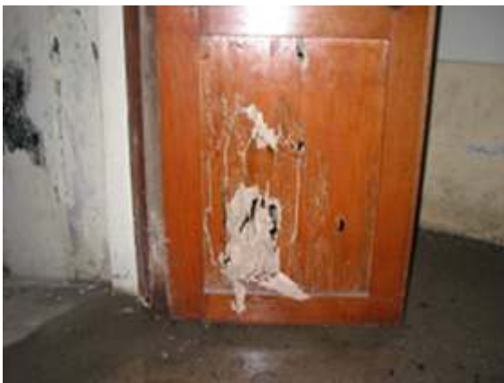
Puerta dañada por termita subterránea.
