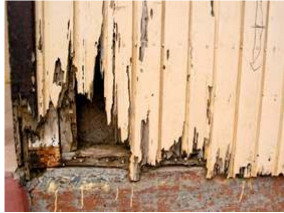
Foto 33: Daño en pared externa de vivienda, Reticulitermes flavipes .
