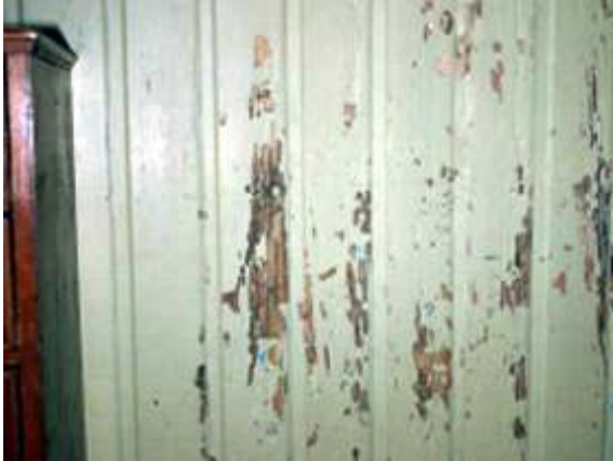
Pared de vivienda dañada por termita subterránea.
