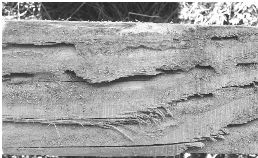
Foto 3: Vista del daño interno en la viga.
